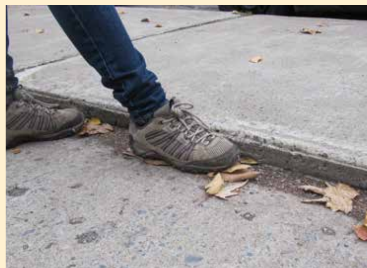
Dénivellation sur le trottoir de la 13 e Rue
