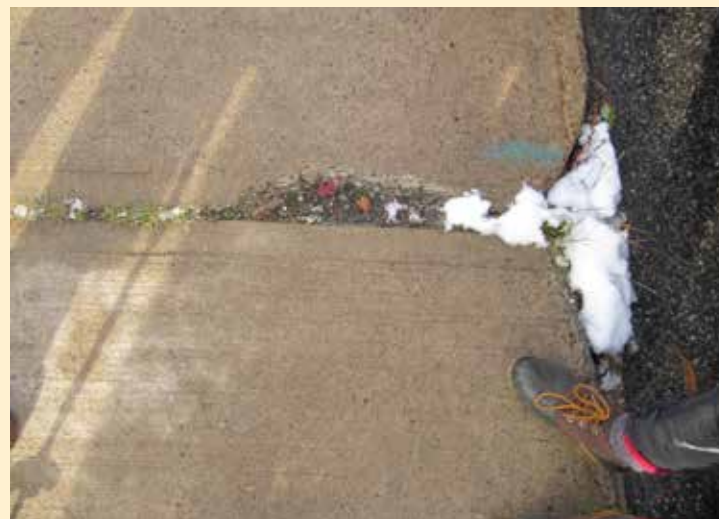
Trottoir endommagé sur l'avenue des Grenats
