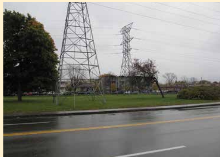
Ligne électrique sur la 41 e Rue
