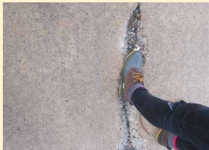
Trottoir endommagé sur l'avenue des Grenats
