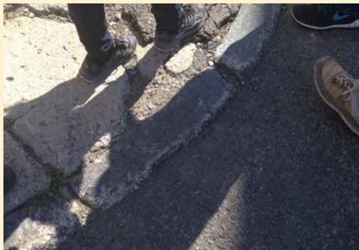
Abaissement de trottoir endommagé
