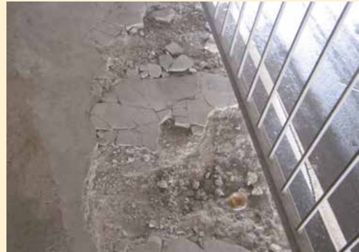
Trottoir endommagé sous le viaduc de la 4 e Avenue Est
