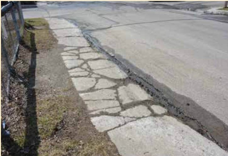
Trottoir endommagé du côté ouest de la rue Loyola
